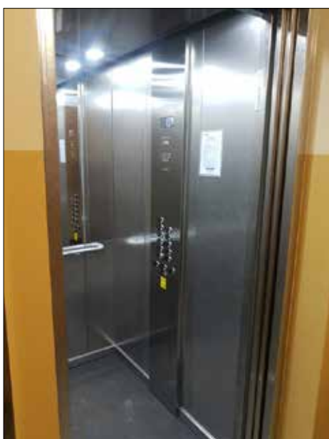
Modernizacja dźwigu osobowego ul. Rybnicka 13
