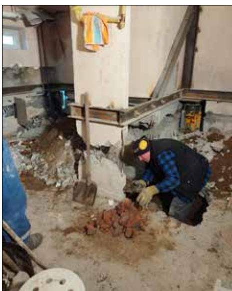
Konserwatorzy Administracji w akcji – remont poziomu sieci kanalizacyjnej w budynku przy ul. Wojciecha 35-35B
