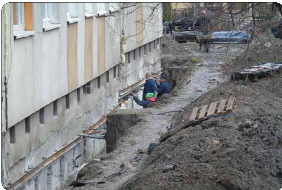
Osiedle Giszowiec – rektyfikacja budynku przy ul. Wojciecha 39 - 39B
